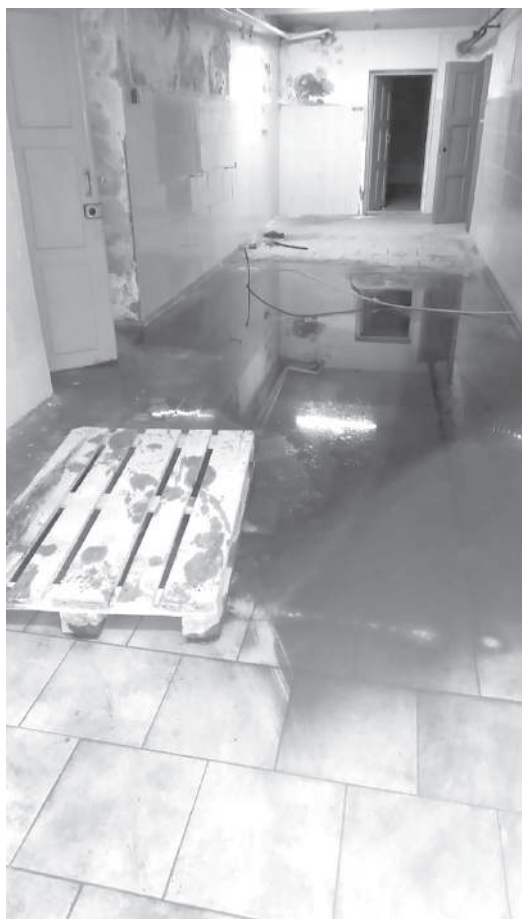
Дырявая крыша приводит к очевидным последствиям
